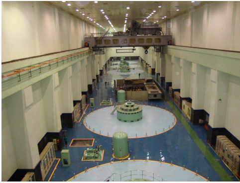
刘家峡水电站
